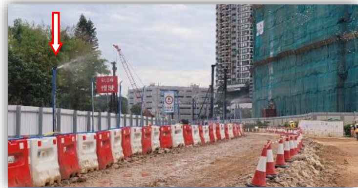
自動灑水系統減少塵土飛揚 Automatic sprinkler system for dust suppression
