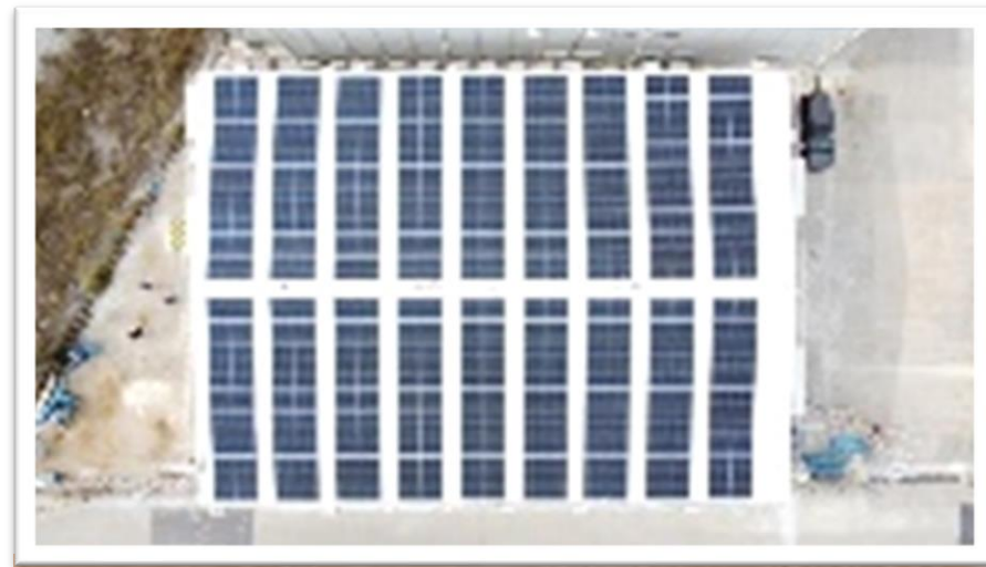
深水角工務區域試驗所天台的太陽能光伏板 Solar panel on the roof of PWRL(SSK)
